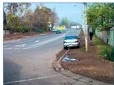
Acera no consolidada
